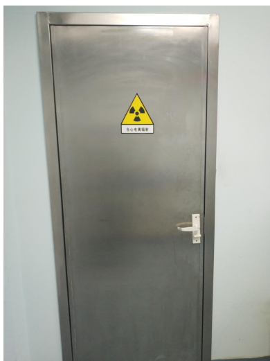
DSA 机房医生防护门
